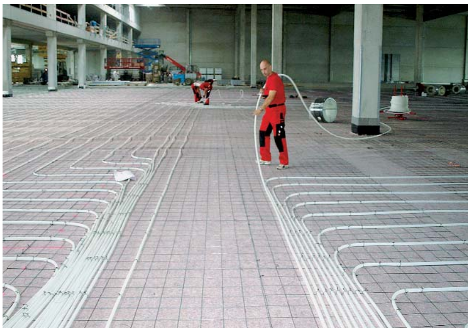
Immer mehr Investoren in Großhallen entscheiden sich für Flächenheizungen. (Foto: Kreilac)
