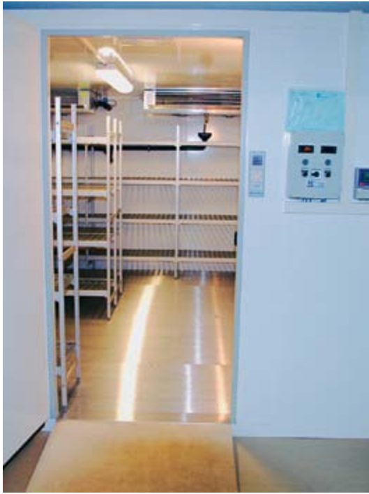
Befahrbare Tiefkühlzelle. Eine ausreichende Luftzirkulation unter dem Bodenblech ist nur schwer zu realisieren. Der sichere Unterfrierschutz ist auch hier die Flächenheizung im Unterbeton (Bilder: Kreilac)
